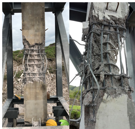
分别受到中度和极度破坏的混凝土柱。
